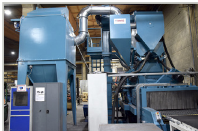
Tämän vuoden alussa asennettu OMSG-sinkopuhallusratkaisu toimii linjan yhteydessä.
