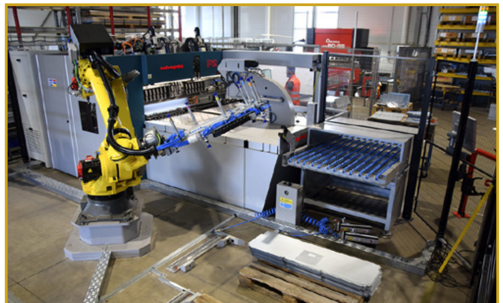
Uutta Salvagnini -taivutusautomaattisolu vahvistaa tuotantoa Forssan LVI-Valmisteella. Kyseessä on samalla uuden teknologian ensiasennus teollisuuteen.
